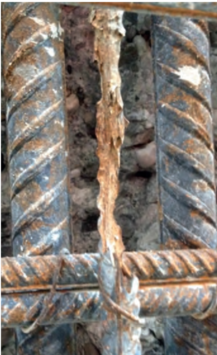
Abb. 4: Chloridinduzierte Korrosion an Bewehrungsseisen
