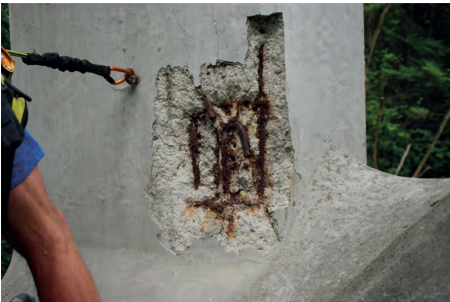
Abb. 1: Betonabplatzung infolge Bewehrungskorrosion
