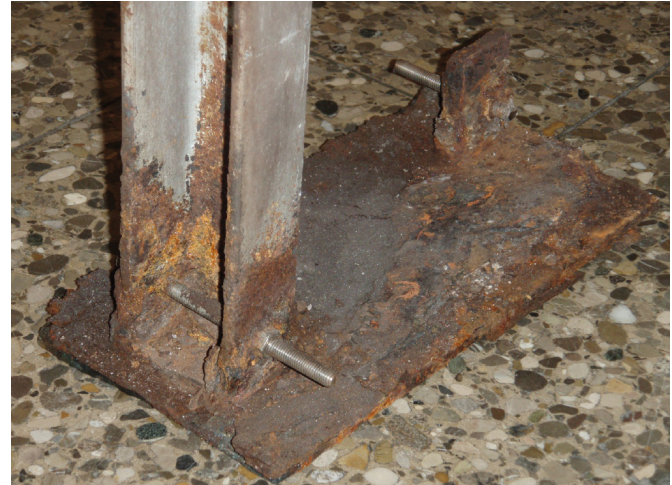
Bild 3. Korrodierte Fußplatte der Unterkonstruktion der Innenverkleidung Fig. 3. Corroded plate of the base structure of the interior lining
