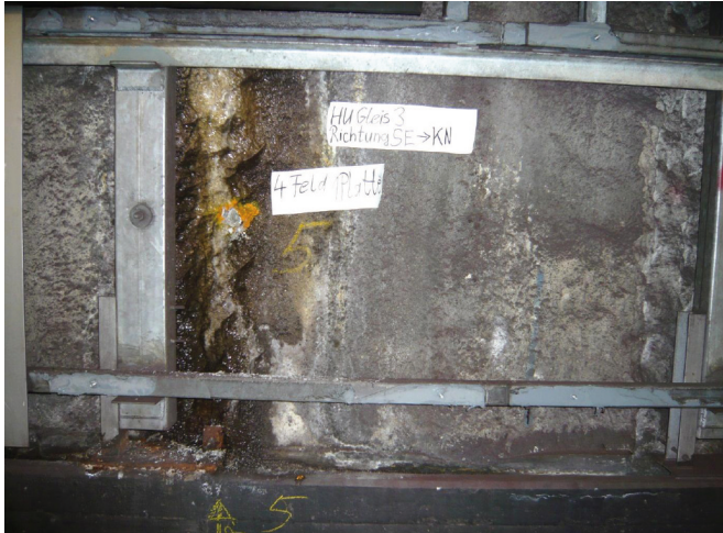
Bild 2. Wassereintritt an der Schlitzwand und Korrosionsschäden an der Unterkonstruktion der Innenverkleidung Fig. 2. Water ingress on a diaphragm wall and the corrosion damages of the interior lining of the base structure
