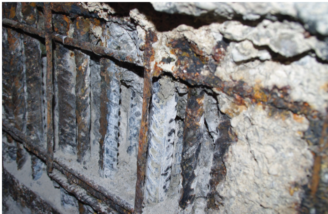
Bild 6. Korrodierte Schlitzwandbewehrung gesehen in der Probeschachtung Fig. 6. Corroded reinforcement of the diaphragm wall discovered in the inspection pit
