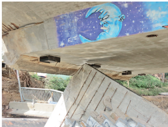
5 Havariierter Zustand des Überbaus © Becker Ingenieure GmbH
